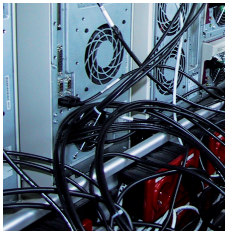
Es sollte darauf geachtet werden, dass die Kabelführung optimal ist, das heisst dass zum Beispiel nicht zu lange Kabel verwendet werden. Foto: C.Nöhren @ pixelio.de
